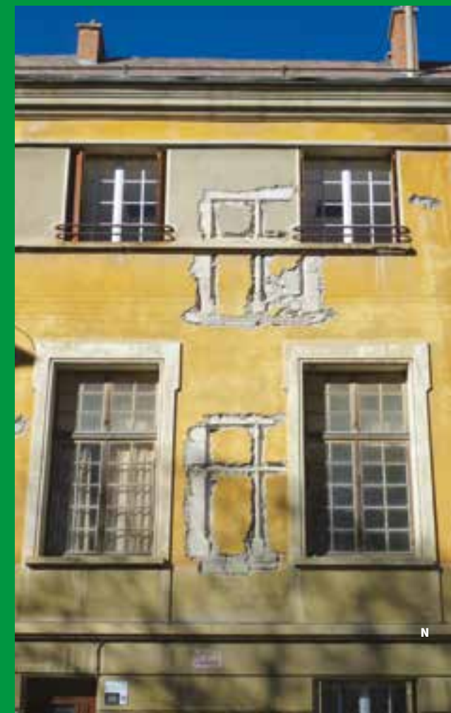
N - Embrun, palais de l'archevêché, façade méridionale, fenêtres à traverse et meneau sur deux étages (XVI e siècle), sondages 2004 © Pays S.U.D., C. Clivio
